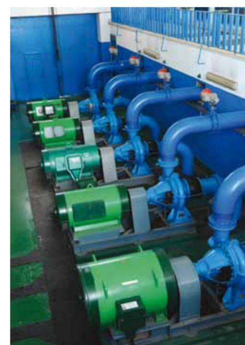
6 Fourniture d'eau potable, station de pompage. Un idéal auquel beaucoup de pays aspirent encore © GDF SUEZ / Antoine Meyssonnier
